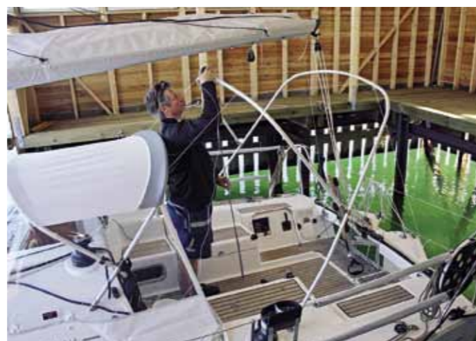
De färdigbockade bågarna monteras fast på båten och spänns upp med linor.
